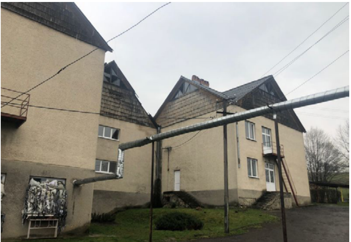
Schule Saritschewo mit marodem Dach
